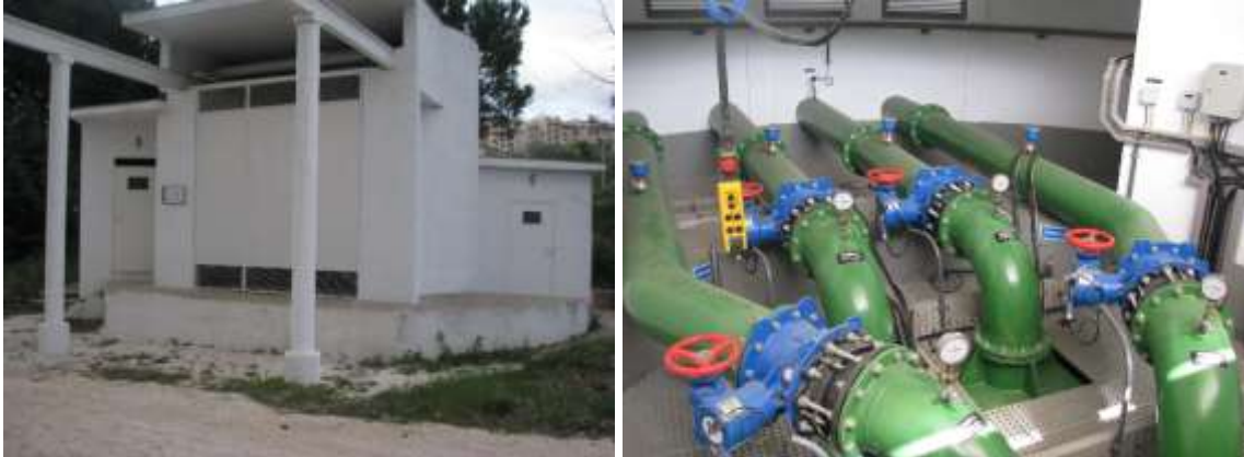
Figura 4 - Fotografias do exterior e da tubagem do Poço de Drenos Horizontais – PDH3
