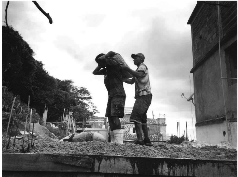
Imagem 43. Construção de laje no Morro do Cantagalo no Rio de Janeiro. (Fotografia de Magno Neves. Projeto Favelagrafia.)
