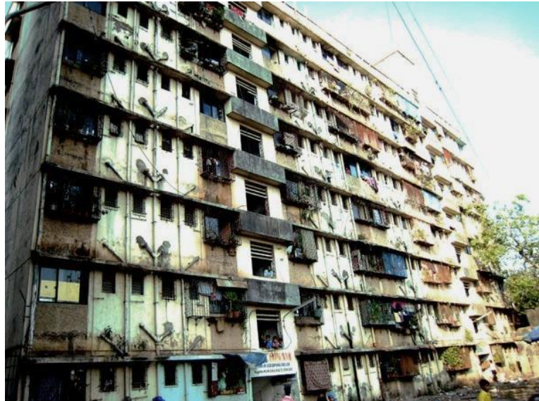
Imagem 60. Edifício De habitação social construído pelo governo em Dharavi por volta dos anos 2000 em degradação.
