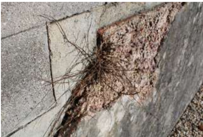
Figura 35: Planta no interior do reboco.
