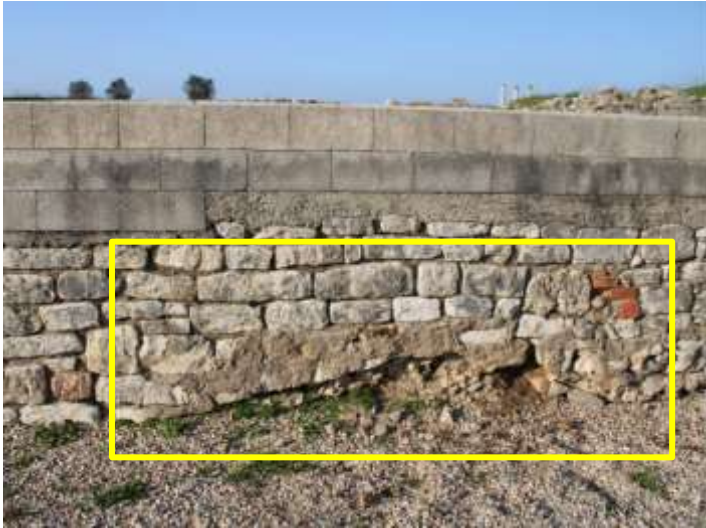
Figura 44: Zona intervencionada com os resíduos de cimento.
