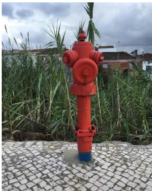
Figura 6 - Marco de incêndio ( Pont-a-Mousson )
