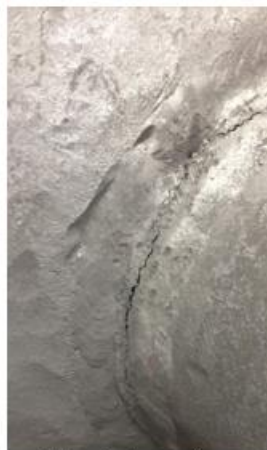
Figura 1- Exemplo de uma fissura exposta
