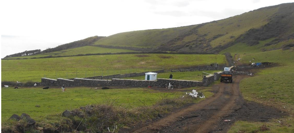
Figura 4.21: Captação da nascente localizada na Serra Dormida - N7.
