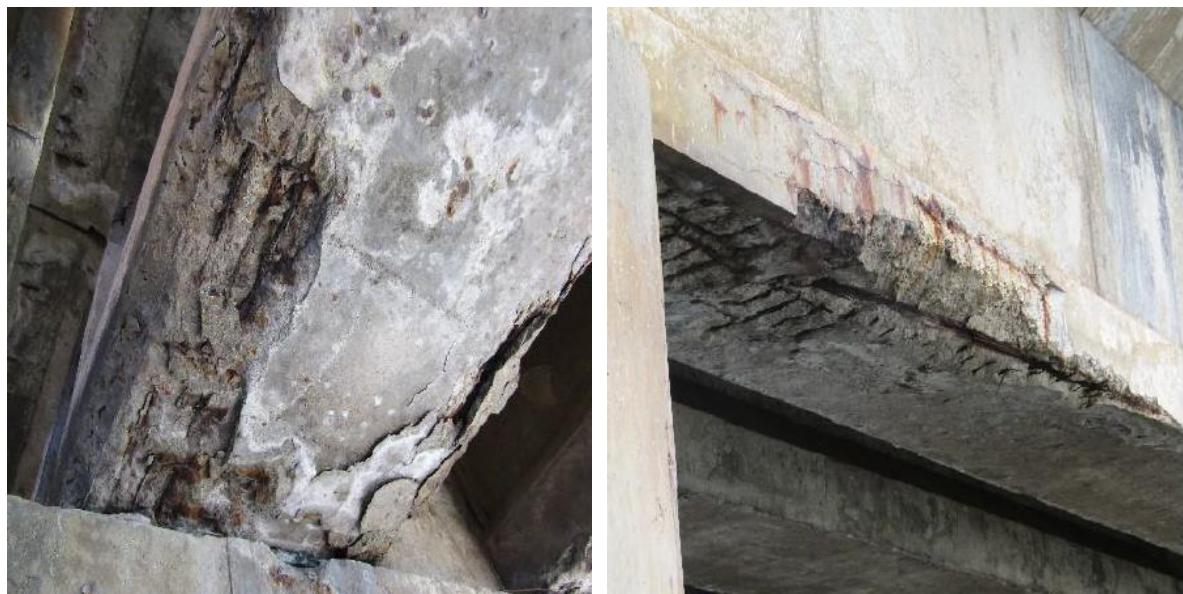
Figura 4.8 – Vigas de betão protendido - Betão desagregado com armadura exposta e oxidada (DNIT, 2018).
