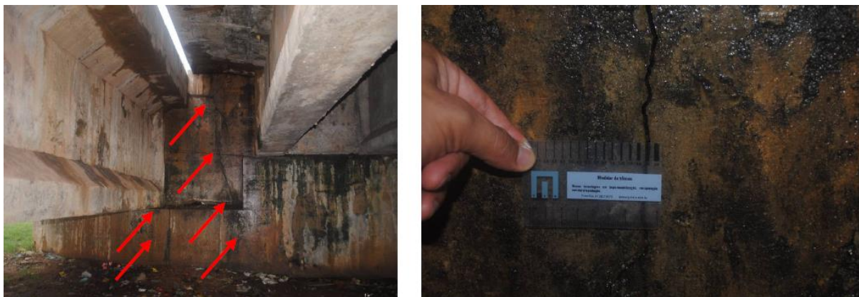
Figura 4.10 - (a) Fissuras no encontro E1; (b) Detalhe da fissura com 2,5 mm (Maia Melo Engenharia , 2012).
