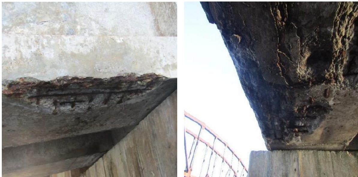
Figura 4.15 – Deterioração do lado esquerdo da estrutura. Corrosão avançada nas vigas de betão protendido (DNIT, 2018).
