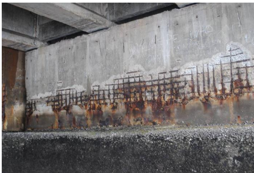
Figura 4.4 – Pilar 8 com corrosão das armaduras (Maia Melo Engenharia , 2012).
