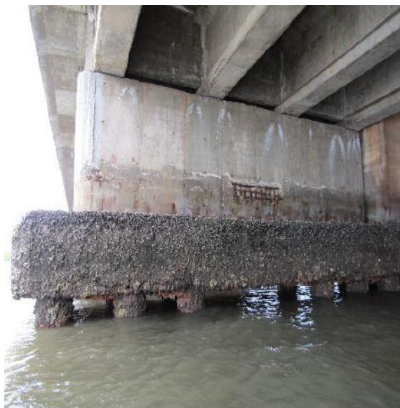
Figura 4.13 – Ataque biológico nos blocos de fundações (DNIT 2018).
