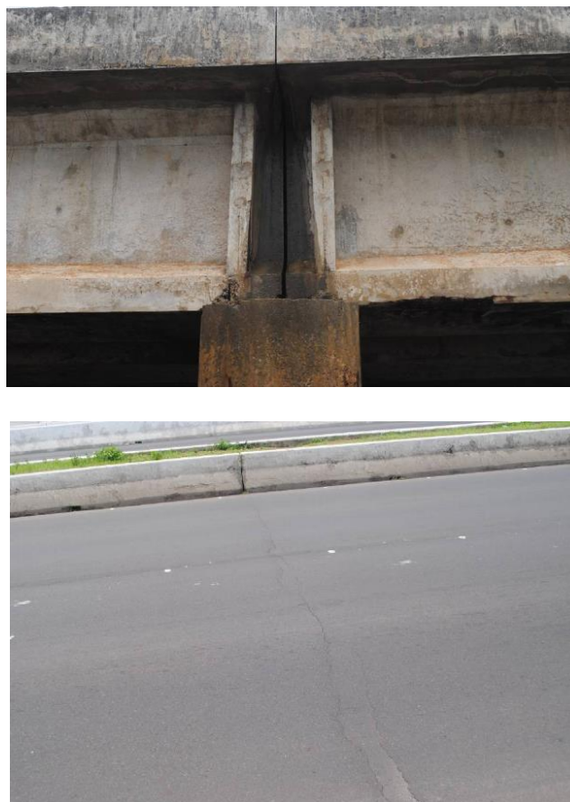
Figura 4.9 - (a) Infiltração causada por deficiência na junta de dilatação; (b) Fissuração transversal no pavimento da ponte (Maia Melo Engenharia , 2012).
