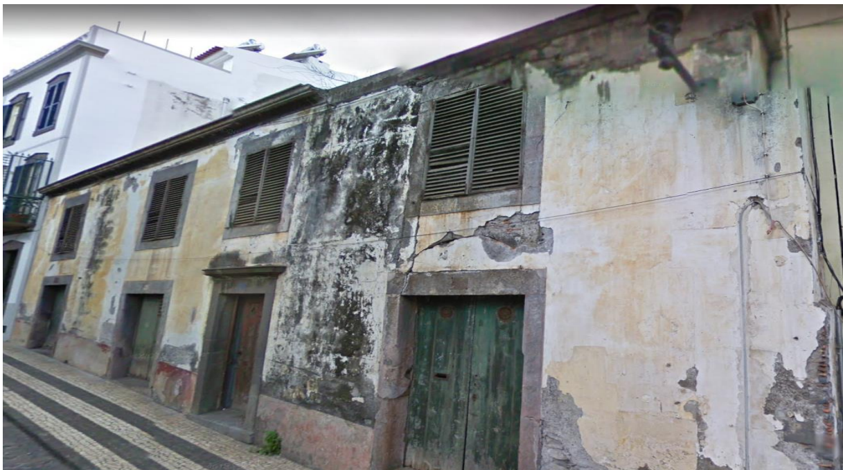
Foto 11 – Edifícios degradados (Município do Funchal)
