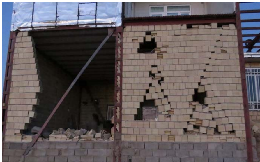
شکل ۱-۲ دیوار جداکننده آسیب دیده در اثر زلزله سال ۱۳۹۶ کرمانشاه- شهرستان تازه آباد (تصویر توسط نگارنده گرفته شده است)
