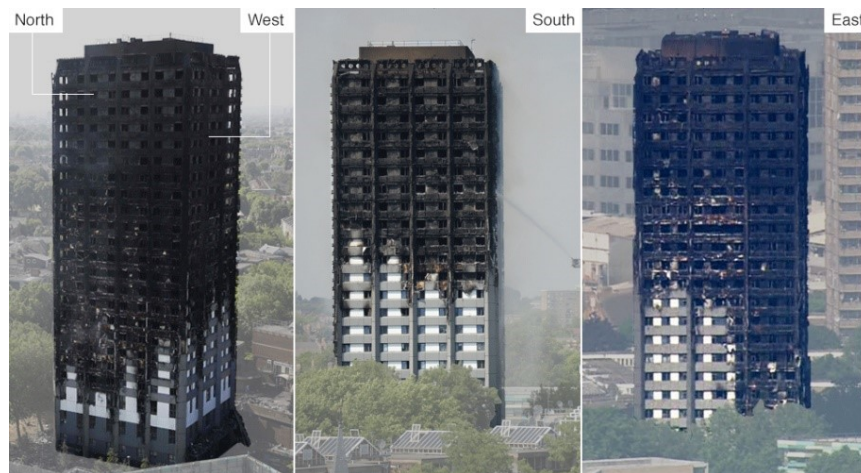
Figura 1.2 – Situação das fachadas do Grenfell Tower após total controle do incêndio (Moore, 2018).
