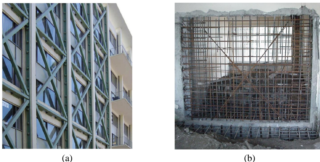
Figura 2.4- Exemplos de reforço global de uma estrutura: (a) adição de contraventamento metálico; (b) adição de parede resistente de betão armado.
