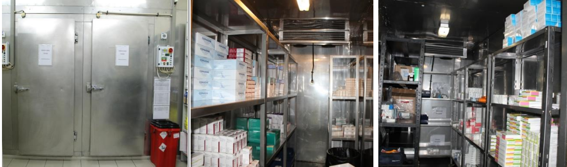
III.2.10 Câmaras de Refrigeração do Armazém Central
