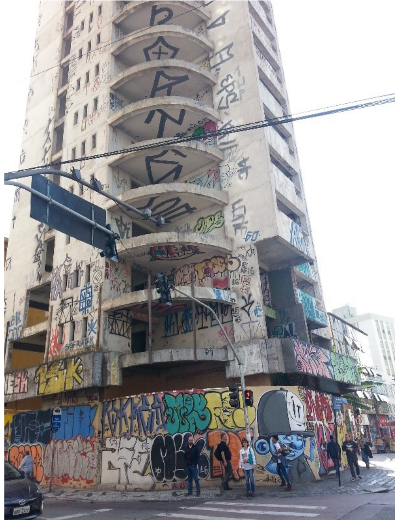
Graffittis e pichações em edifício na região central de Curitiba-PR
