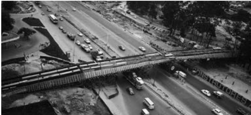
Figura 29: Construção da passarela Ciccillo Matarazzo, 1968-1970; fotos: Ivo Justino, acervo fotográfico do Museu da Cidade de São Paulo
