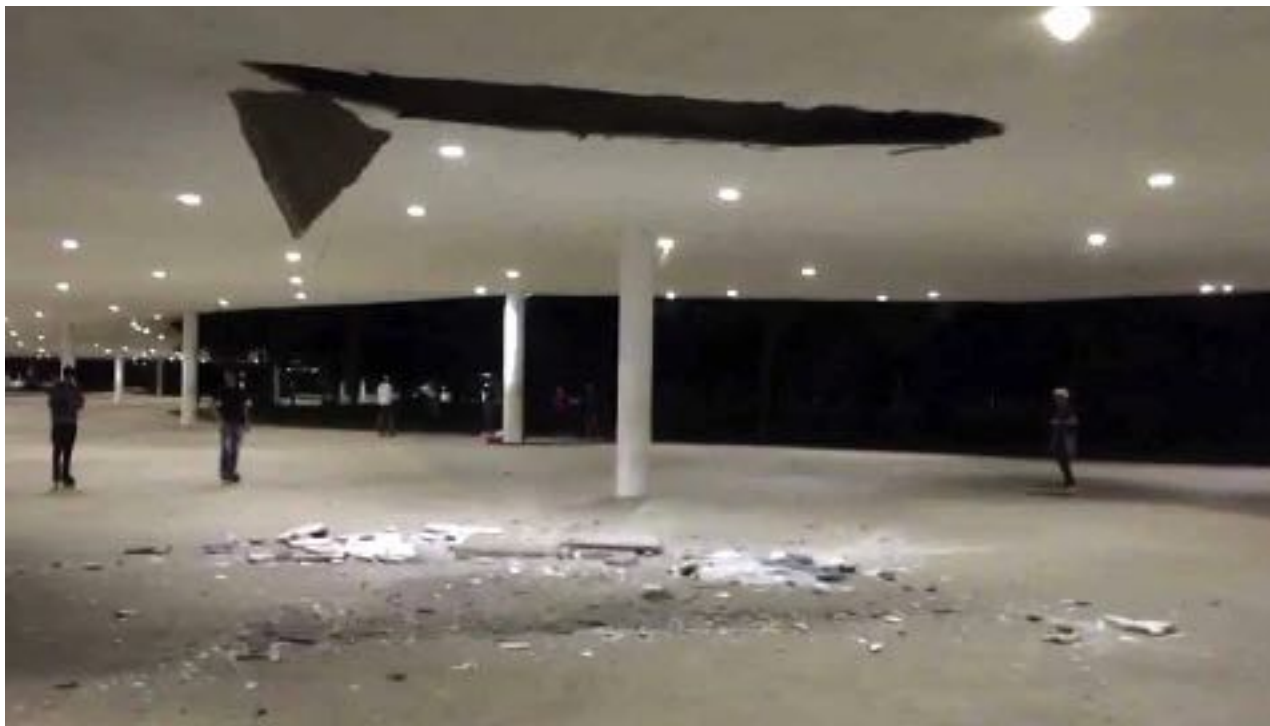
Figura 57: Marquise logo após parte do teto cair, em novembro de 2017; foto: Leandro de Oliveira [TETO..., 23/11/2017]
