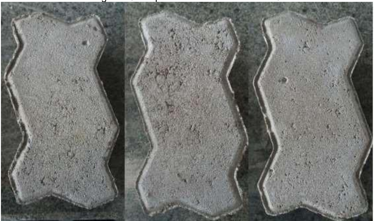
Figura 48 - Aspecto Visual dos Pavers P10
