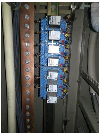
Figura 35 - Relés do quadro
