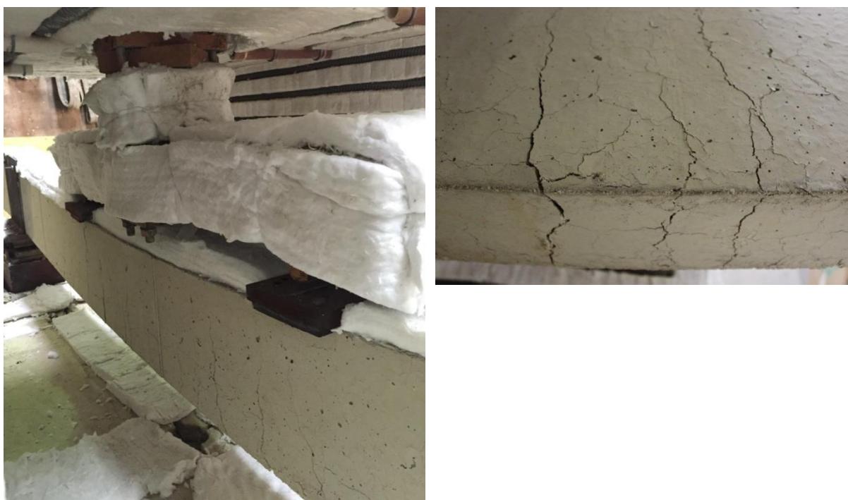
Figura 3.67 – Vista geral das fissuras de flexão e detalhe das aberturas das mesmas na face inferior da viga simplesmente apoiada do ensaio ka0_kr0_1.
