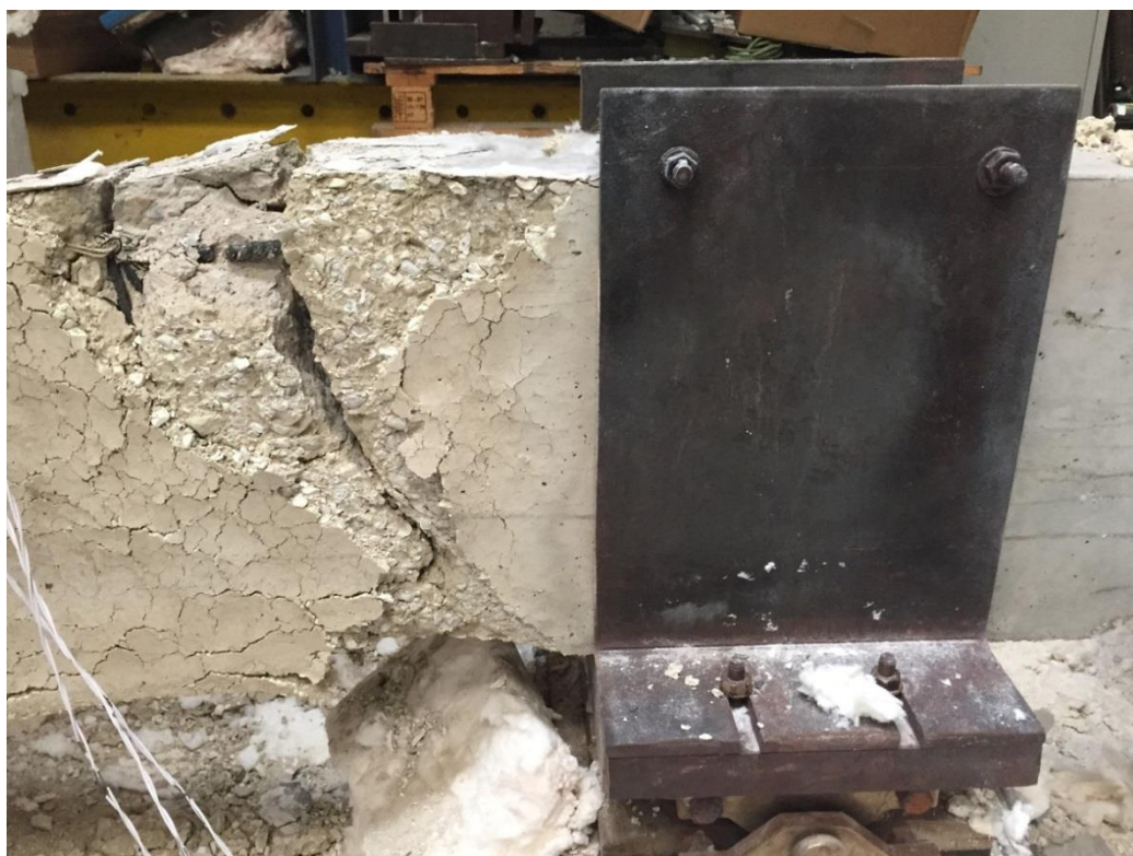
Figura 3.72 – Detalhe da ruptura de uma das armaduras superiores na região próxima ao apoio duplo (região dos momentos negativos) da viga do ensaio ka1_kr2_2.
