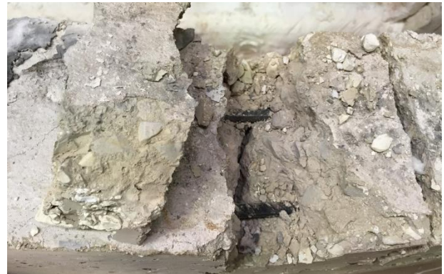
Figura F.35 – Detalhe das armaduras longitudinais superiores, que não romperam no ensaio ka2_kr1_1.
