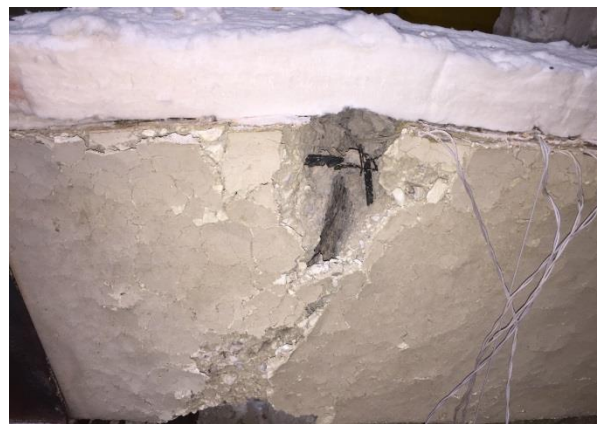
Figura F.44 – Detalhe da região próxima a um dos apoios onde se verificou a ruptura da armadura longitudinal superior, após ensaio ka1_kr2_2.
