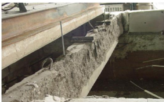
Figura 2.6 – Fenômeno de spalling em viga simplesmente apoiada constituída por concreto de alta resistência após ensaio de exposição a altas temperaturas (CHOI; SHIN, 2011).
