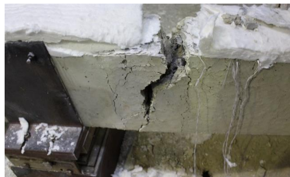
Figura F.29 – Detalhe da ruptura das armaduras longitudinais superiores na região próxima ao apoio simples após ensaio ka1_kr1_1.
