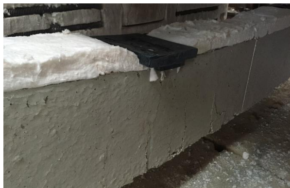
Figura F.17 – Detalhe da aparência “craquelada” da superfície de concreto e das fissuras de flexão após ensaio ka1_kr0_1.
