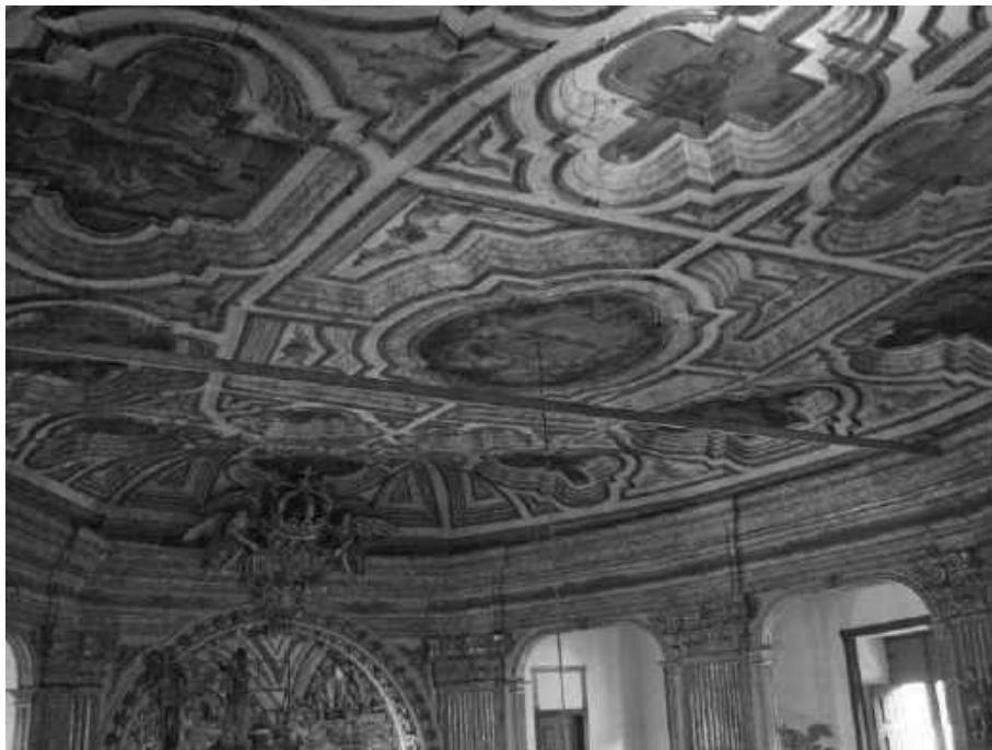
Figura 4 - Parte do forro da nave e “pé-direito” da Epístola
