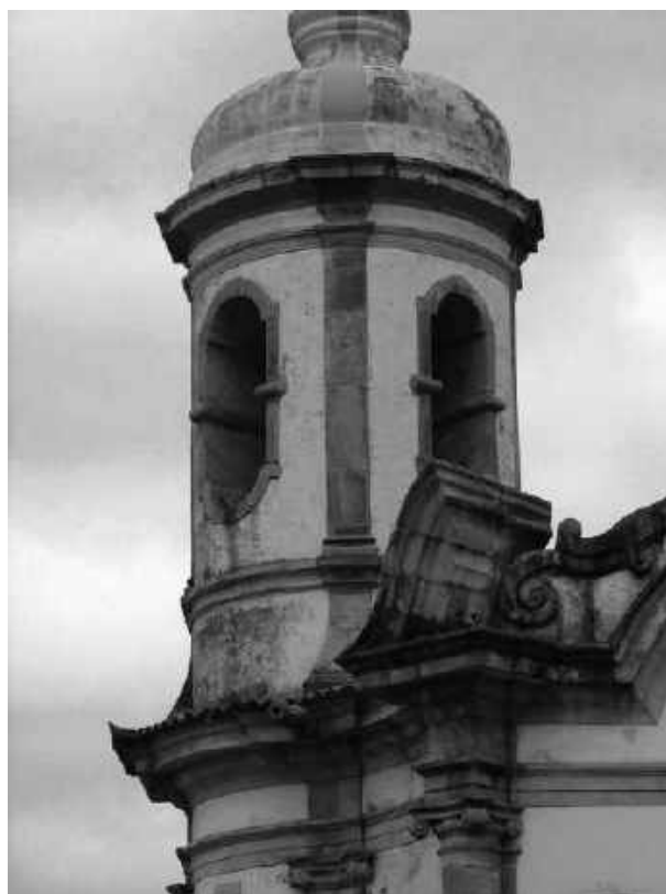
Figura 28 – Torre sineira de São Francisco, com destaque para a ausência de capitel nas pilastras acima da cimalha real
