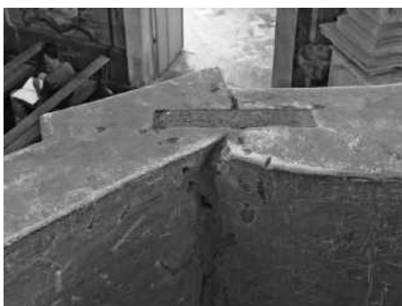
Figura 12 – Juntouro ou “artificiosa ligadura” das pedras dos púlpitos da Capela de São Francisco para garantir solidarização das peças
