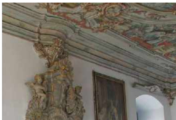
Figura 2A – Detalhe da Figura 2. Vista da sacristia da Capela do Carmo. Destaque para a “represa” acima do lavatório
