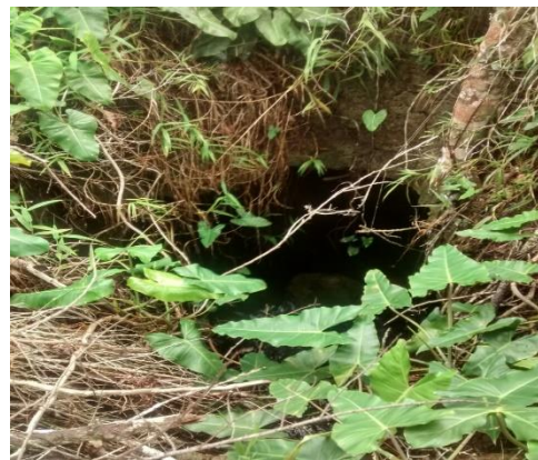
Foto 8.10 - Colapso em subsuperfície gera aberturas no terreno que podem causar acidentes. Foto: o autor.
