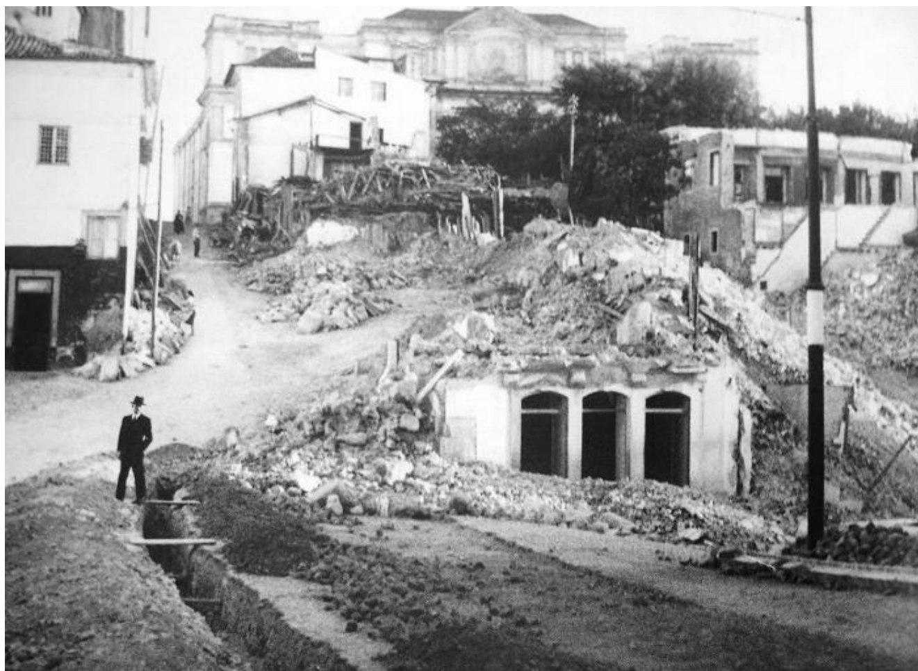
258 – Área demolida para dar lugar à futura Faculdade de Letras. Inícios da década de 1940.
