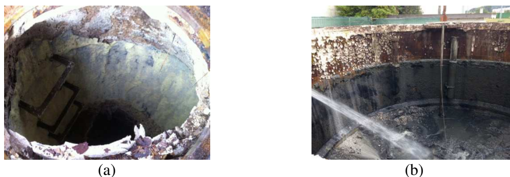
Figura 1.2 – Registo fotográfico evidenciando a degradação de (a) interior de caixa de visita de águas residuais e (b) interior de decantador de ETAR.
