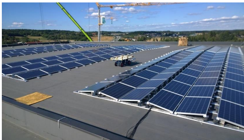
Figura 4 – Sistema BAPV: Instalação de 1482 painéis fotovoltaicos sobre a cobertura de um armazém da ASKO, empresa distribuidora de produtos alimentares, situada em Vestby, na Noruega, numa área de 2500 m 2 e uma potência instalada de 370,5 kW. Os painéis solares encontram-se orientados, alternadamente, para este e oeste de modo a obter a máxima densidade de potência; produção anual esperada de 300 MWh [19].
