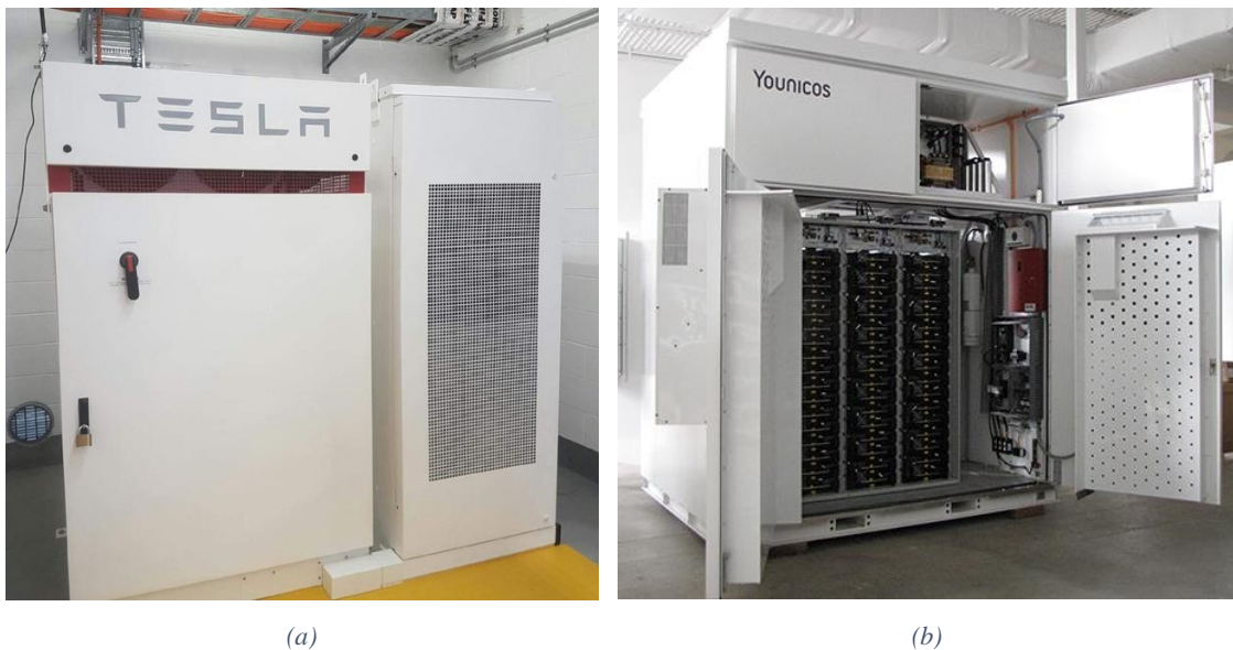
Figura 6 – Sistemas integrados de baterias de íões de lítio: (a) Powerpack da Tesla com uma capacidade de armazenamento de 95 kWh e respetivo inversor [24]; (b) Y.Cube pertencente à Yunicos, desenvolvido em parceria com a Panasonic com capacidade de armazenamento desde os 222 kWh [25].
