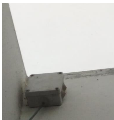
Figura 62 - Caixa onde se encontram os IC
