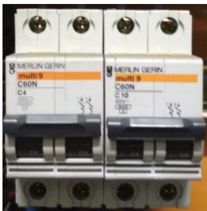
Figura 61 – Exemplo de contactores do quadro do autómato
