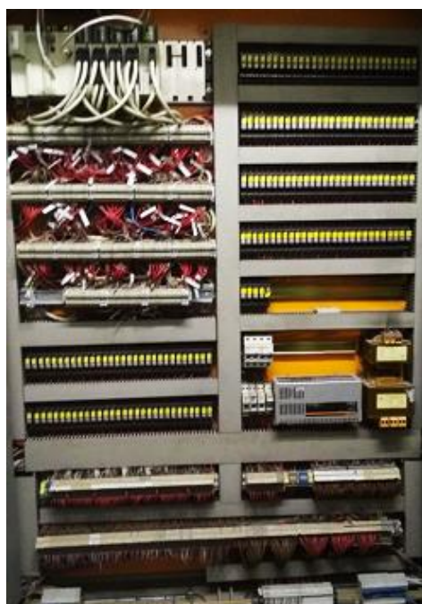
Figura 57 – Quadro do Autômato TSX P57-2634M instalado na sala de segurança
