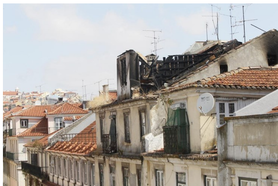
Figura 13 - Fotografia incêndio urbano da Baixa de Lisboa (Fonte:
