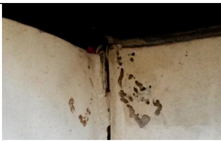
Figura 219: Galerias provocadas por insetos
