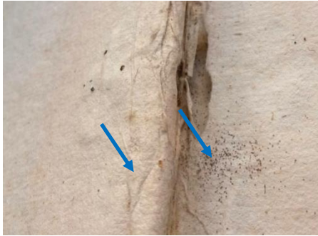
Figura 255: Manchas de humidade e de corrosão de tinta e enrugamento de folha
