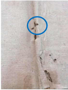
Figura 301: Galerias causadas possivelmente por insetos
