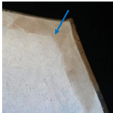
Figura 303: Mancha de humidade
