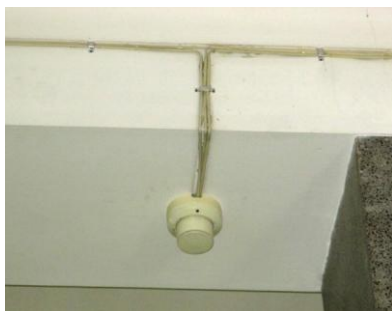
Figura 47: Detetor de incêndio
