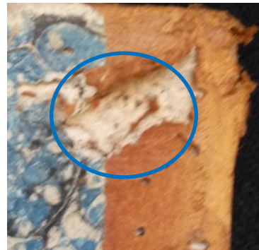
Figura 290: Lombada deteriorada, provavelmente, por ataque de insetos ou roedores
