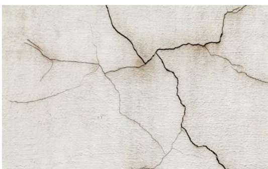
Figura 3.1 - Fissuração potenciada pelo fenómeno de retração (retirada www.mapadaobra.com.br ,2016)
