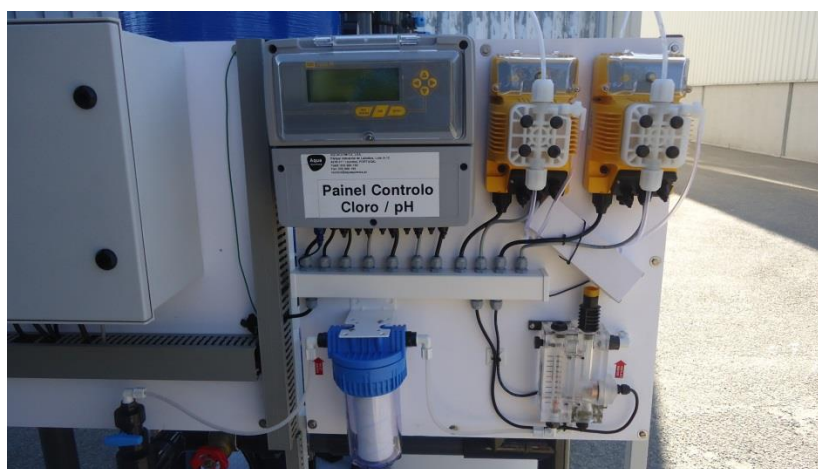
Figura 29 - Painel de Controlo de Cloro (Materiais Gráficos AQ, 2016)
