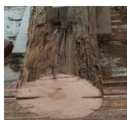
Figura 3.2- Pormenor da degradação mecânica e biológica visível nas vigas de madeira antiga.
