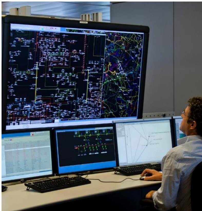
Figura 13 – Estação de Automação.
