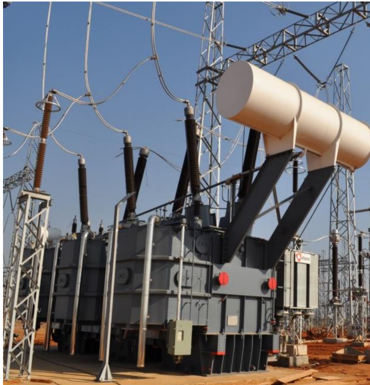
Figura 10 – Transformador de Potência.
