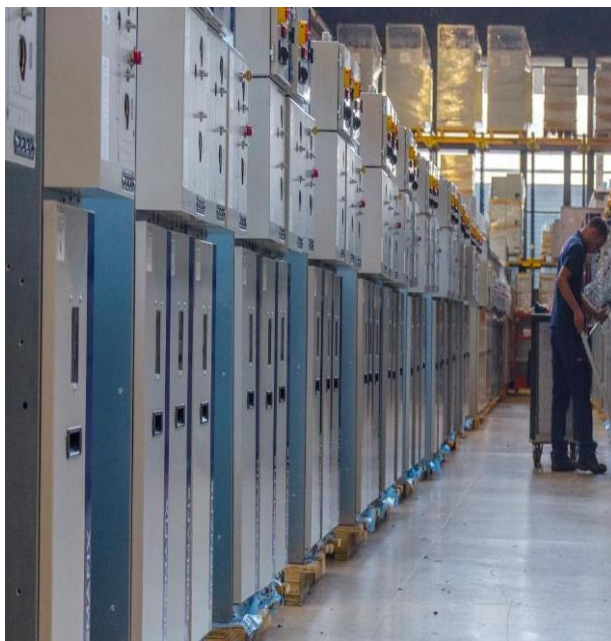
Figura 11 – Aparelhagem de distribuição primária.
