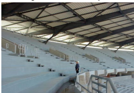
Figura 1.3- Vigas de cobertura do Estádio Cidade de Coimbra, Coimbra, Portugal (TAL PROJECTO@, 2003).
