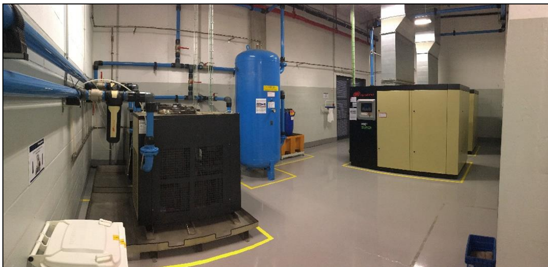
Figura 8 - A sala dos compressores da BWP.
