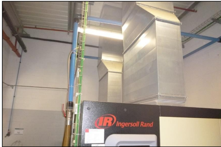
Figura 22 - Conduatas de extração do ar quente resultante do arrefecimento dos compressores.
