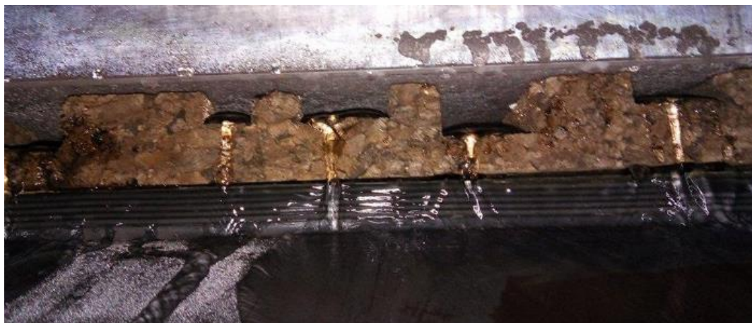
Figura 4.23 – Drenagem verificada na solução MD50 “bar code” à saída do dispositivo
