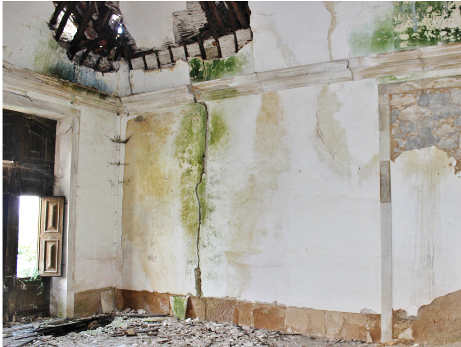
Figura 2.11 – Antiga sala de jantar (Ao centro do primeiro piso, ou andar nobre, do volume dianteiro)
