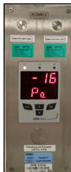
Figura 7.6. Transmissor de pressão diferencial instalado à entrada de uma sala de fabrico.
