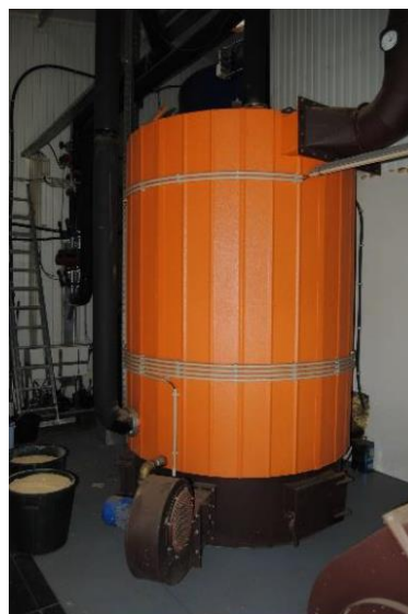
Figura 3.2 Caldeira da instalação
