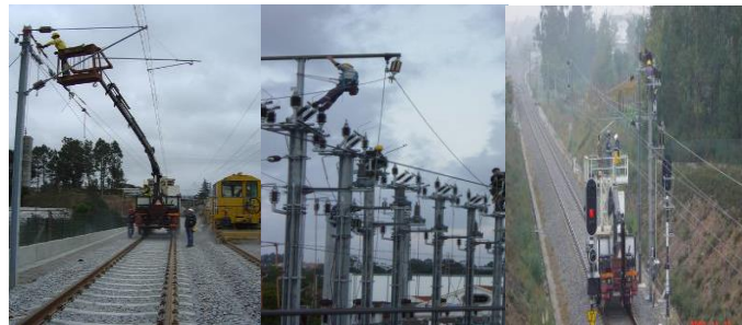
Figura 4 - Equipamento trabalhos de catenária
