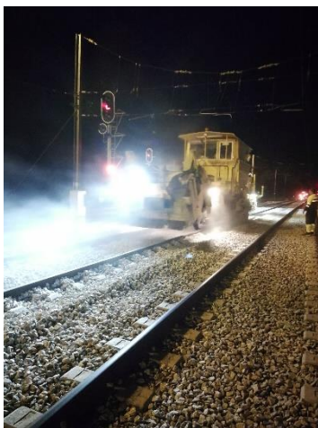
Figura 18 - Reguladora de balastro
