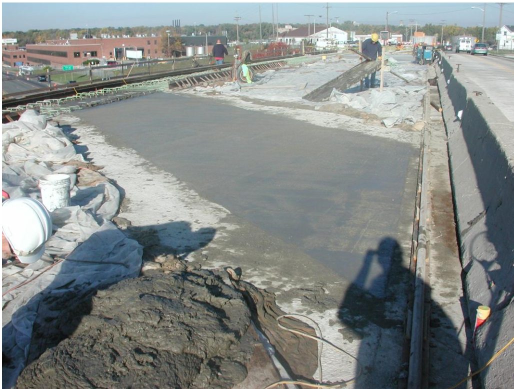
Fig.22: Substituição da junta de dilatação por trecho em ECC na ponte de Grove Street.
