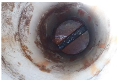
Figura 2.4 – Infiltração na câmara de visita (foto cedida por INOVA, s/d).
