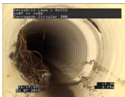
Figura 2.7 – Anomalia na junta do coletor devido a raízes (foto cedida por INOVA, s/d)
