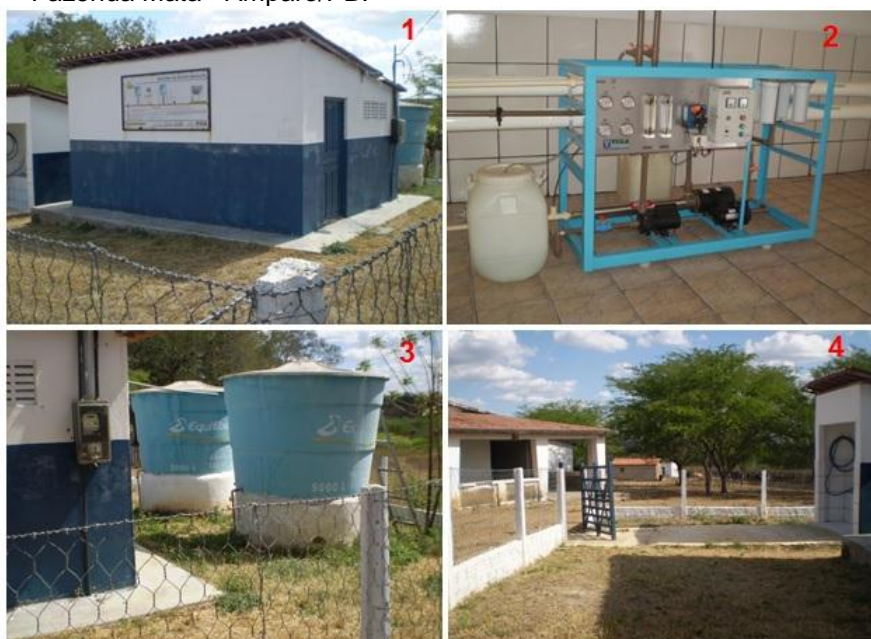
Figura 13 – Abrigo do sistema de dessalinização (1); dessalinizador (2); reservatórios de água bruta (3); e chafariz (4) da Unidade Demonstrativa, Fazenda Mata - Amparo/PB.
