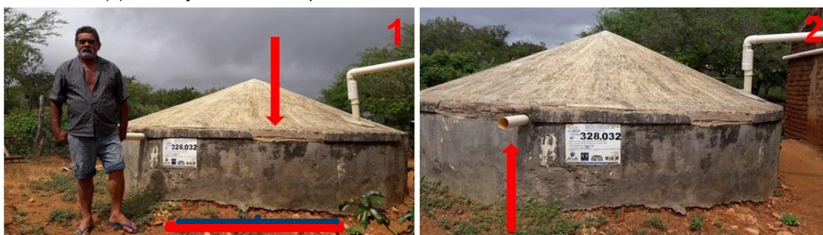
Figura 19 – Imagens da Cisterna apresentando rachaduras e bastante deteriorada (1), sem a bomba manual e com a saída d’ água desprotegida (2) em Poço do Boi – Amparo/PB.
