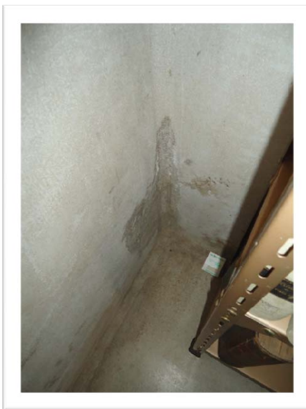
Fig. 2 – Presença da humidade nas paredes e no piso
