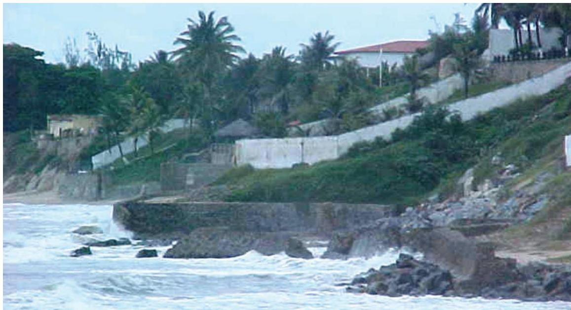
Figura IV.4.2.18: Destruição dos muros das casas e desestabilização de enrocamentos pela ação erosiva das ondas na praia de Iparana, na Região Metropolitana de Fortaleza. Fonte: Morais et al. (2006, p. 147).
