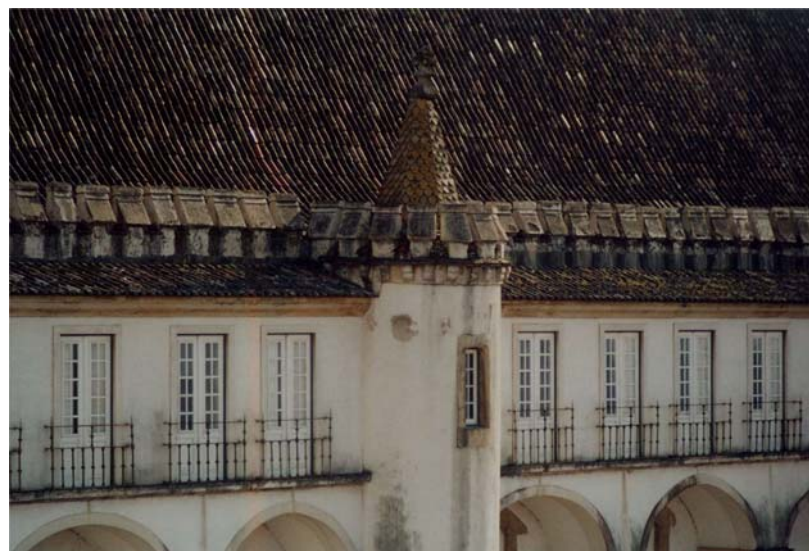
Aspecto da fachada norte, observando-se a ocultação da cachorrada, entre os cubelos, pela cobertura da galeria alta no século XVIII.
