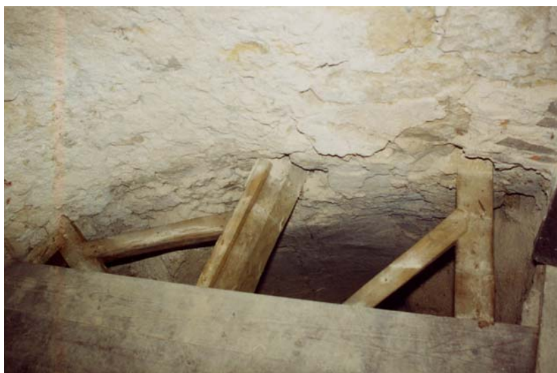
Cubelo norte da porta-forte. Aspecto do piso de soalho após a remoção das primeiras tábuas.
