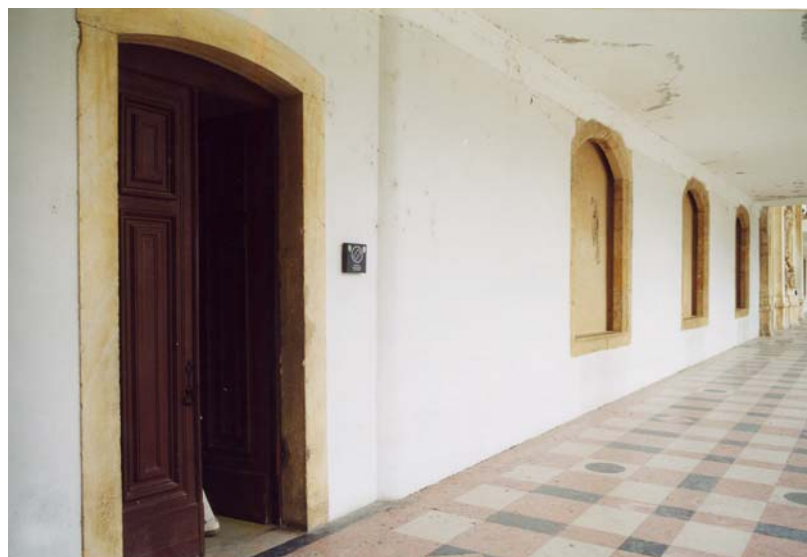
Aspecto da fractura existente entre a Sala Grande e a guardaroupa , no interior da Via Latina .
