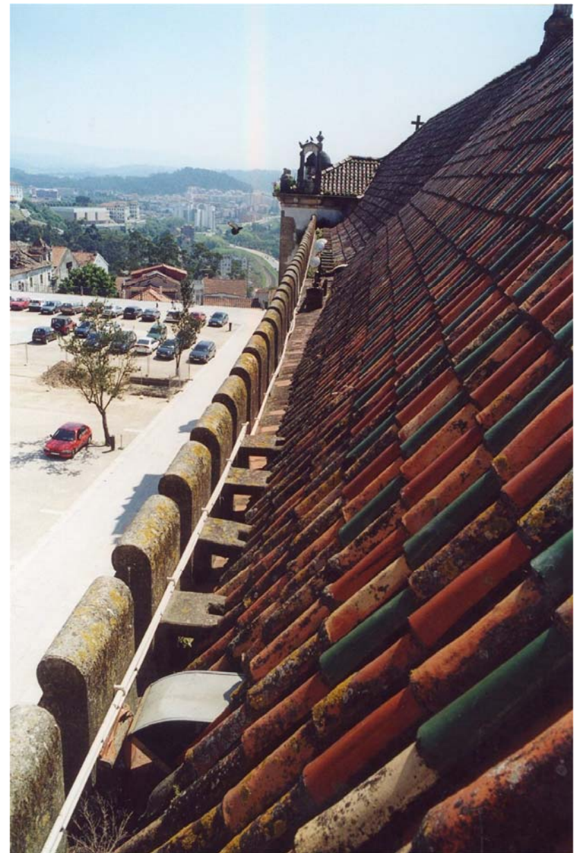
União do corpo da Capela ao dos aposentos da Rainha vista ao nível das coberturas.
