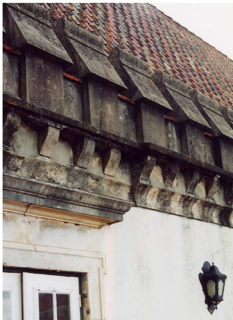
Detalhe da união deficiente da cimalha.
