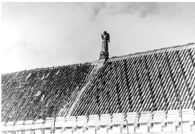
Perspectiva das duas tipologias de merlões, antes das intervenções dos serviços oficiais (DGEMN, foto 186).
