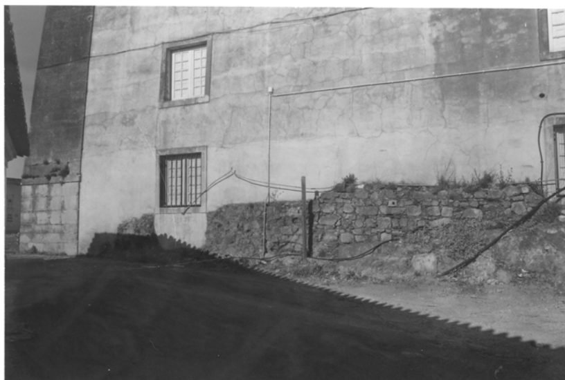
Aspecto dos muros arcaicos postos a descoberto pelos movimentos de terras na base do paramento poente dos Geráis .
