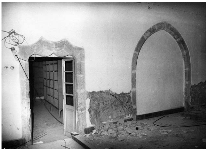
Perspectiva da porta de serviço, com a verga recortada e da porta cocheira, larga, de arco quebrado e arestas chanfradas, durante os trabalhos de recuperação do andar térreo (DGEMN, foto 733).
