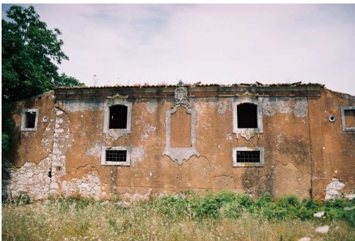
Figura1. Casa do Monge lagareiro, Ataíja de Cima, S. Vicente de Aljubarrota. Fonte: A Maduro
