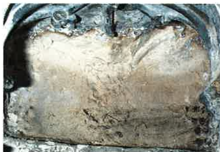
Sem tampa – é visível a mutilação dos elementos decorativos.
