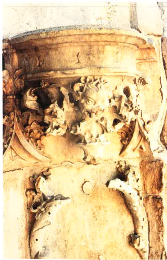
Fig. 16. Fachada de Santa Cruz. Mísula no grande pilar lateral à direita.
