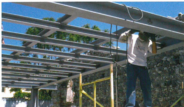
Figura 6. Solução estrutural em aço com percepção de sistema construtivo adotado para a cobertura do edifício.
