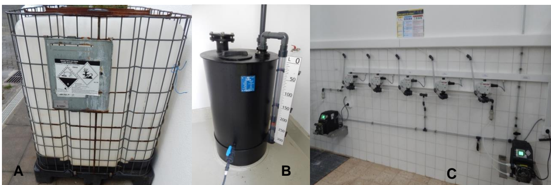
Ilustração 2 – Depósitos de transporte (A) e armazenamento (B) de hipoclorito de sódio e linhas de doseamento (C). (Fonte EPAL)
