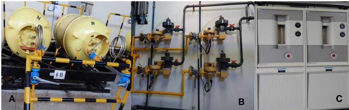
Ilustração I – Garrafas de cloro gasoso (A) e linhas de cloro (B) com clorômetros (C). (Fonte EPAL)
