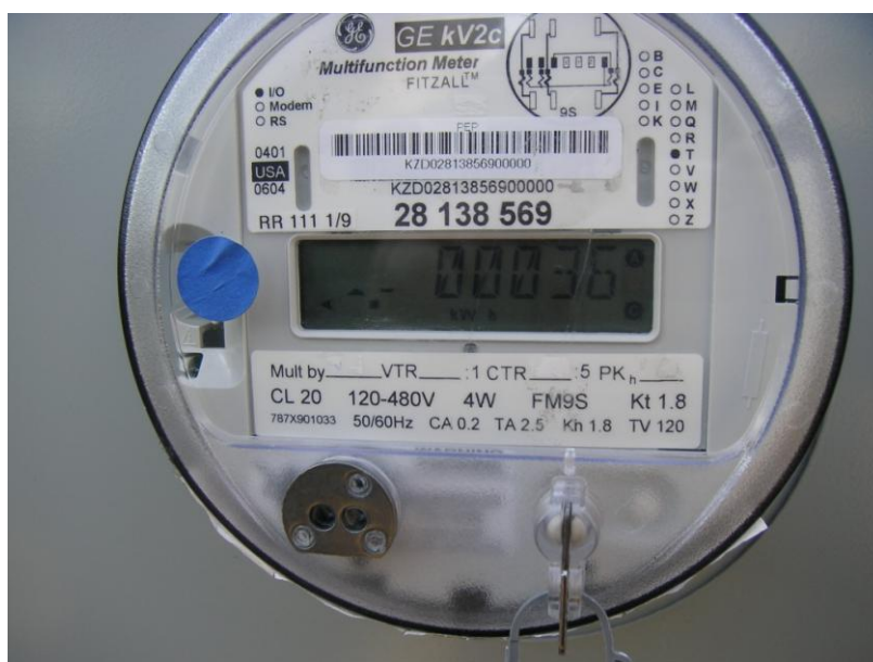
Figura 7 - Exemplo de um contador bidirecional utilizado em net metering
