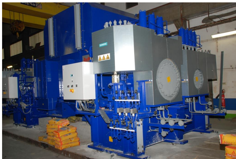
Figura 5.4. Posicionamento das turbinas.
