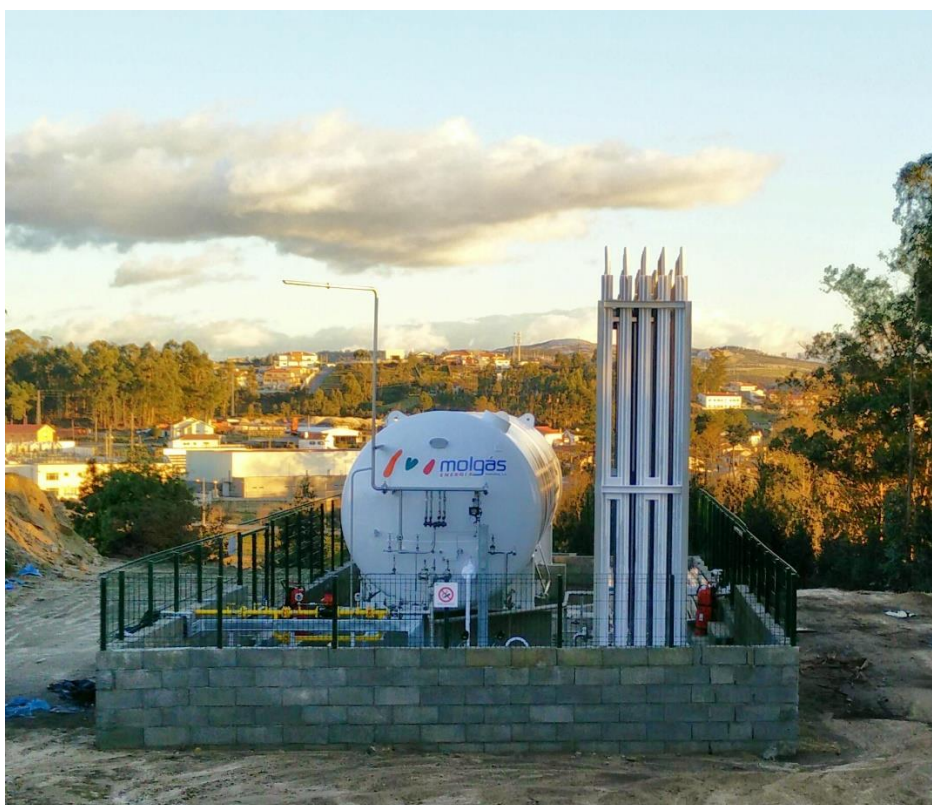
Figura 6. Unidade Autónoma de Regaseificação da Molgás Energia Portugal, S.A.
