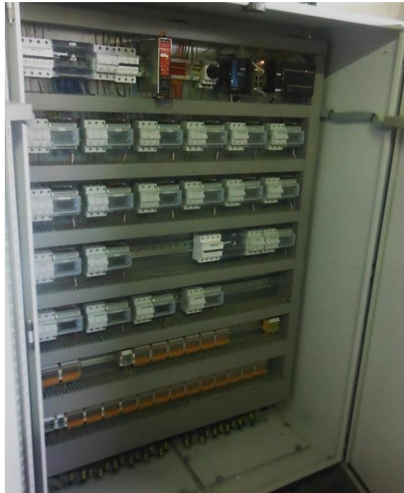
Figura 6 – Quadro Global de Baixa Tensão (QGBT1 e QGBT2).
